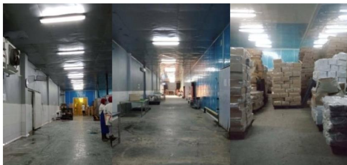
Gambar 7. Kondisi langit – langit dan dinding
