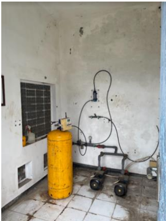
Gambar 8. Ruang Klorinasi Reservoir Bangkon
