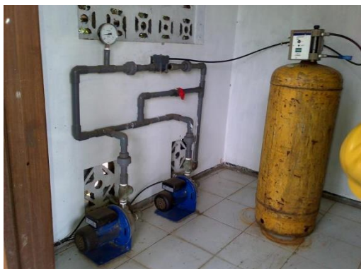
Gambar 5. Instalasi Alat Klorinasi
