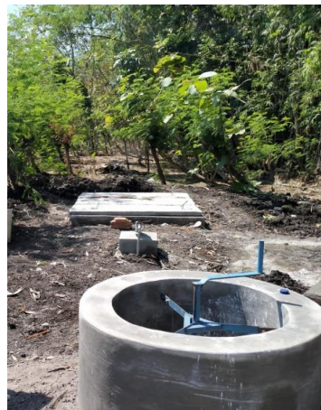
Gambar 13. Instalasi Biogas Sumber: Dokumentasi Pribadi
