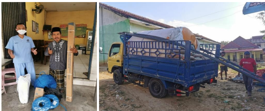
Gambar 6. a) Pembelian tali dan pompa submersible, b) Pengiriman tandon air ke lokasi.
